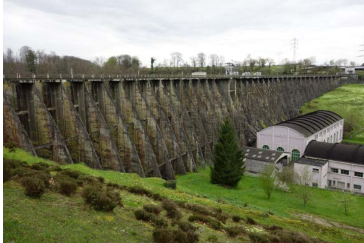
Illustration 7: vue de l'aval du barrage de Vezins montrant notamment les nombreux contreforts et les butons, poutres en compression qui les joignent (Photo CGEDD)
